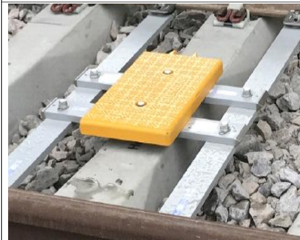
KTCS-2 설비: 현장정보전송장치
