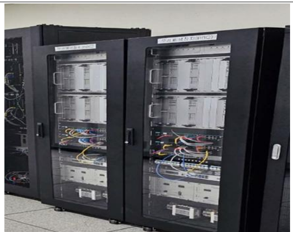
KTCS-2 설비: 무선폐색장치(RBC)
