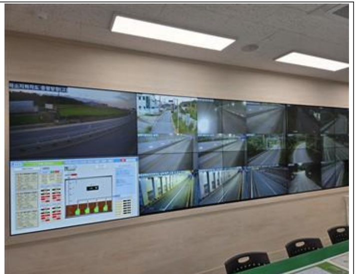
상황관리(CCTV, 배수펌프 모니터링)
